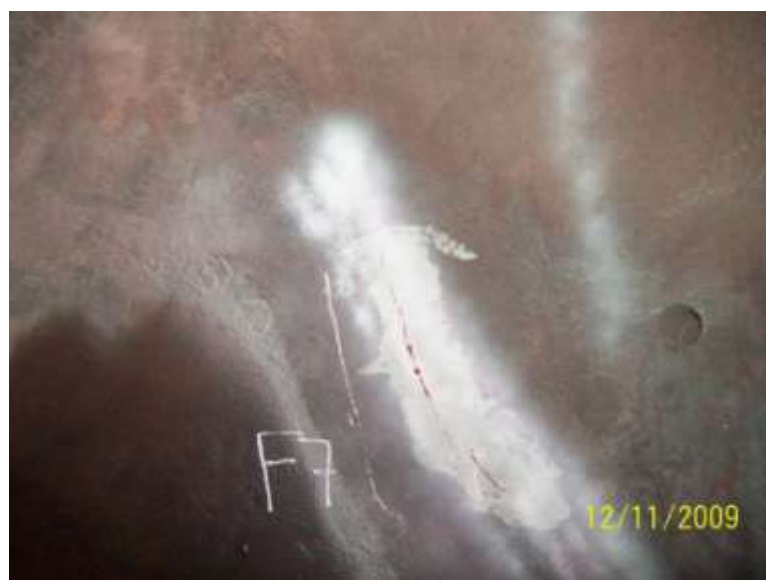
FISURA : se encuentra en el mismo casquete que la fisura N° 6 con la diferencia que esta se sitúa en la parte de vapor, su longitud es de 140 mm.
