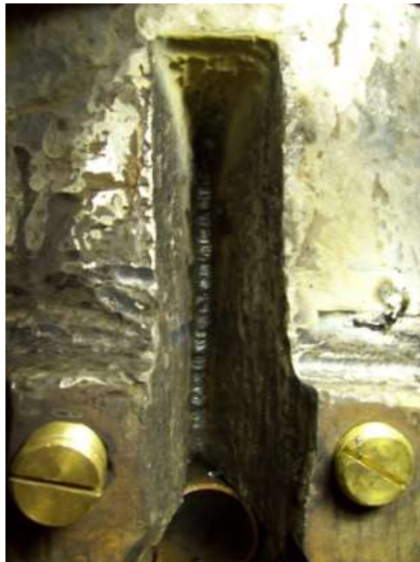
Reparación de Fisura en Cilindro Prensa
