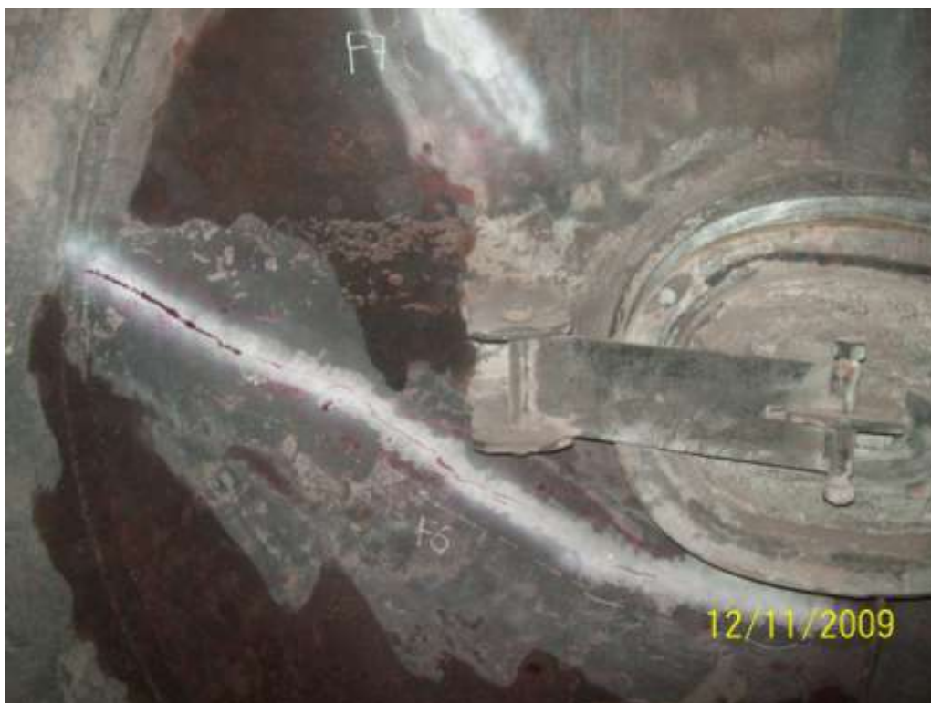
FISURA Se encuentra en el casquete sur en la parte húmeda, es la más importante de las encontradas su longitud es de 900 mm. la misma tiende a ramificarse al final.
